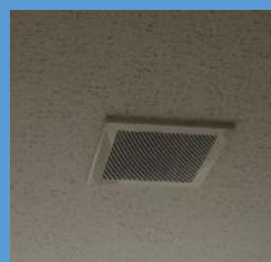
天井設置の換気装置
